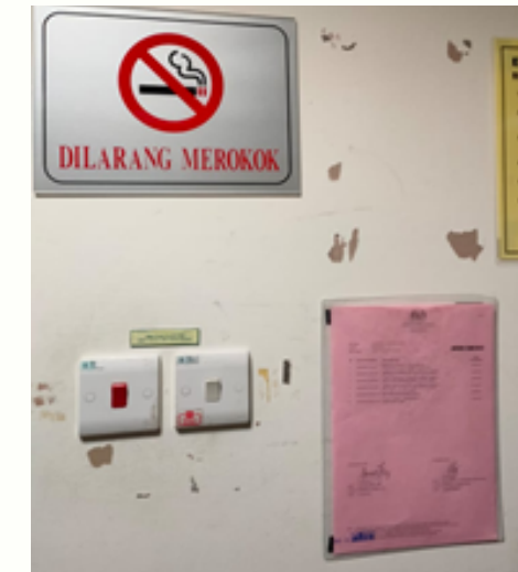
kesan tampalan dan cat tertanggal pada dinding
